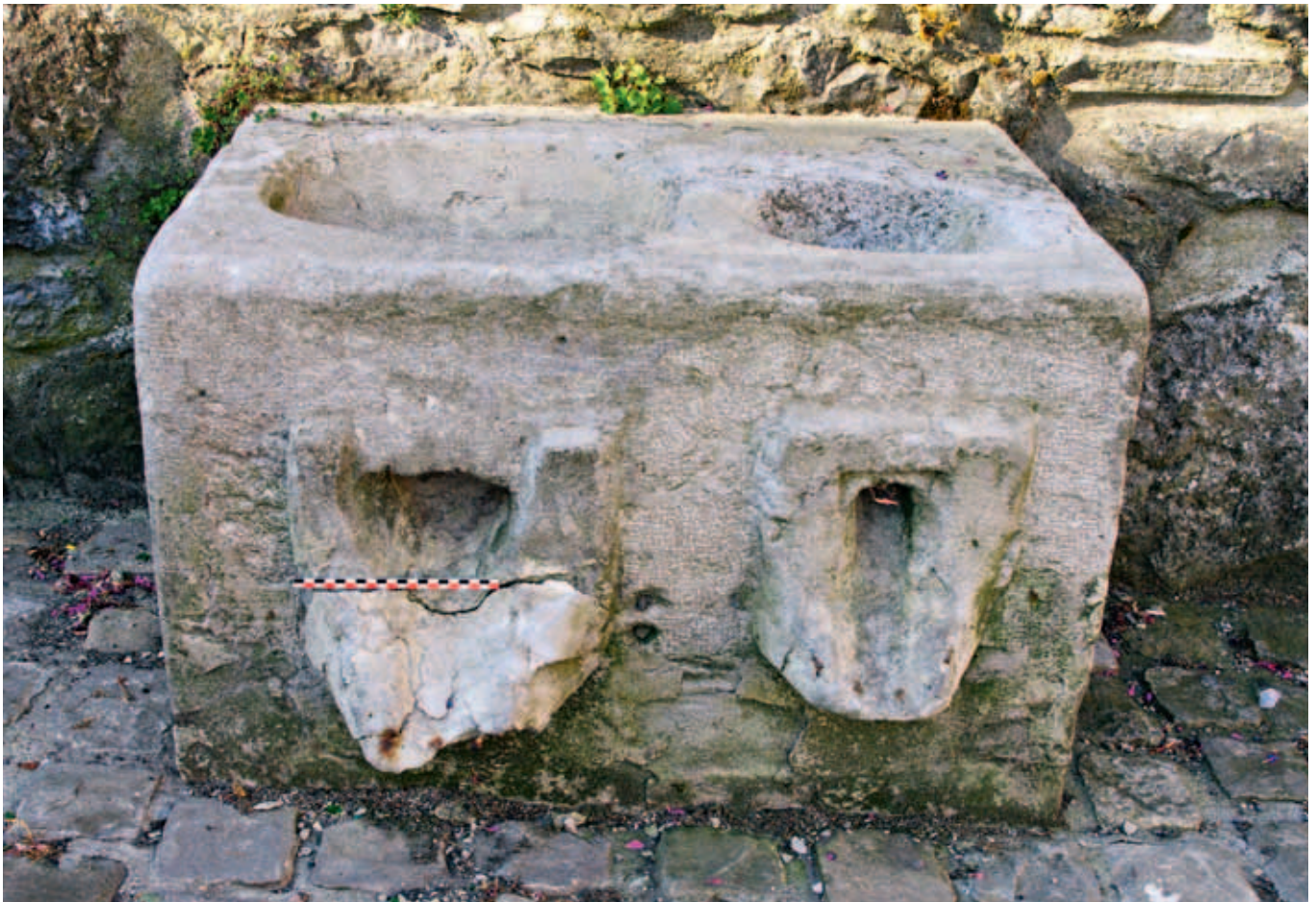
Vue de la pierre de capacité de Viuz. Passablement remaniée au XX e siècle elle porte différentes rustines de ciment et surtout deux becs en béton qui ont été greffés au niveau des déversoirs. La présence de ces becs rajoutés au cours de ces dernières années est incohérente avec le mode de fonctionnement de ces mesures en pierre. Heureusement le stationnement des véhicules proche des mesures se charge de les faire disparaître...
